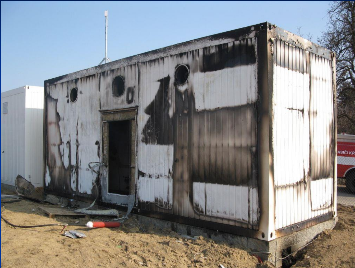
2. šíření požáru po kabelech – fotovoltaická elektrárna
