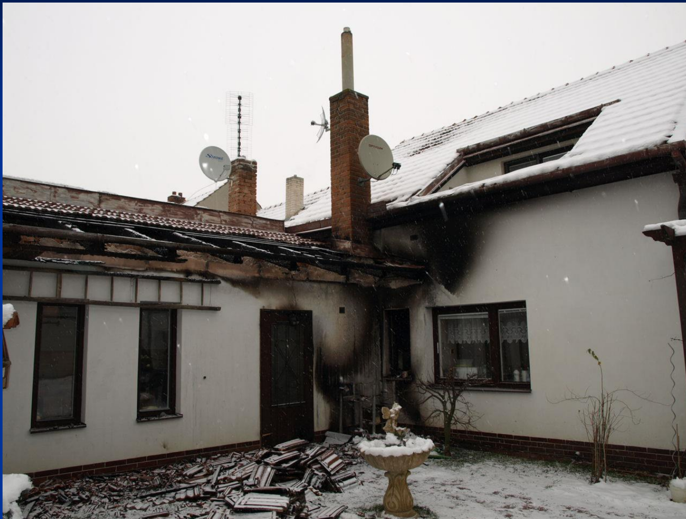
1. typický ohniskový kužel při požáru rodinného domu
