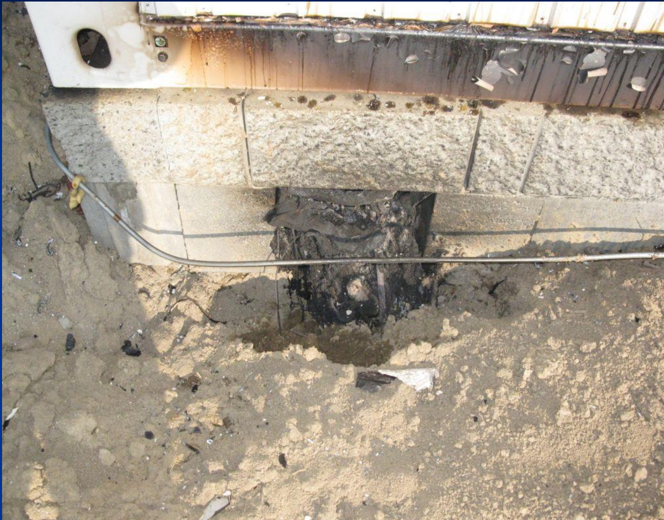
3. šíření požáru po kabelech – fotovoltaická elektrárna
