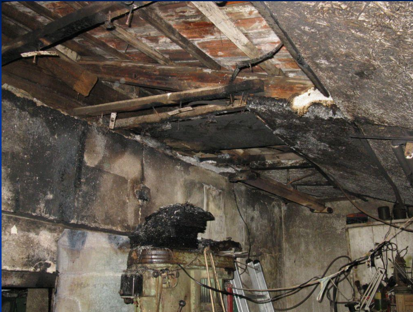
9. požár dílny v rodinném domě od el. instalace – šíření po el. kabelech ve vrstvě zateplení polystyrenem
