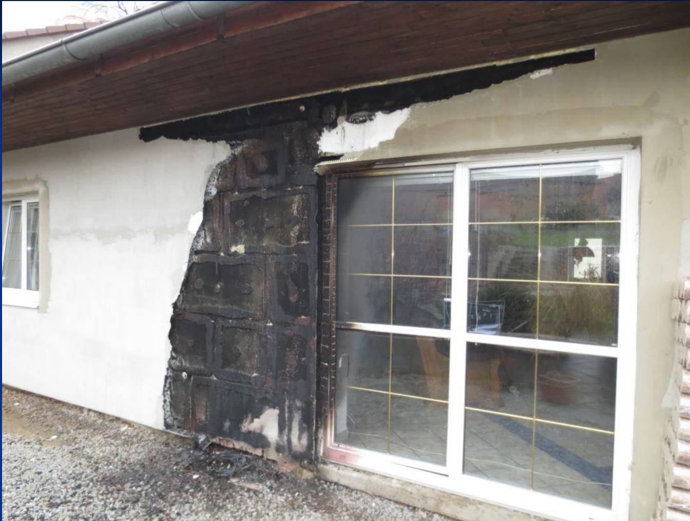
11. typický ohniskový kužel při požáru zateplení fasády rodinného domu
