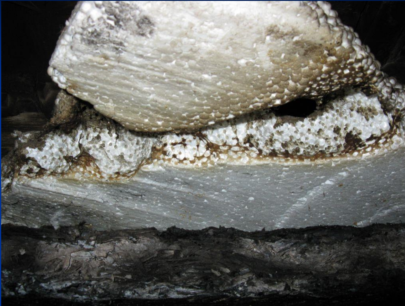
10. požár dílny v rodinném domě od el. instalace – šíření po el. kabelech ve vrstvě zateplení polystyrenem
