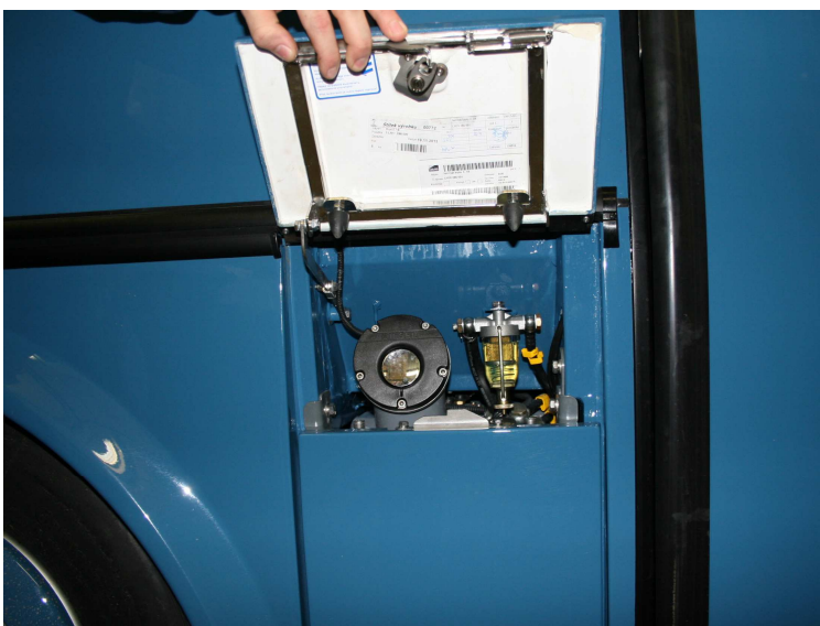
Obrázek 56: Čistič paliva u nalévacího hrdla nádrže vozu se standardní výškou podlahy
