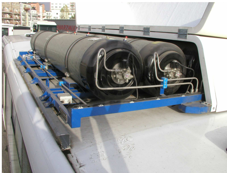
Obrázek 25: Upevnění rámu tlakových nádrží na střeše vozidla. Dobře jsou vidět panty krytů tohoto prostoru 10
