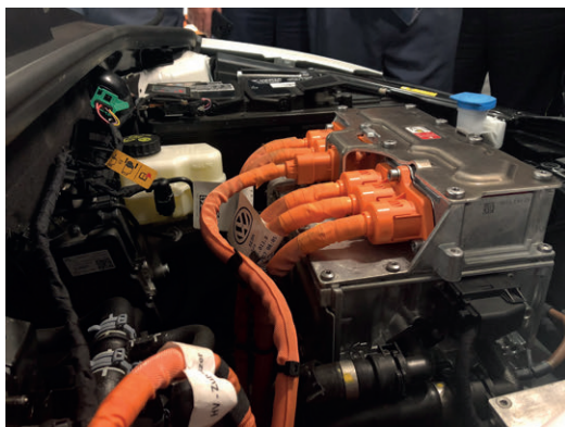
Obr. č. 25.13 Oranžová HV kabeláž
