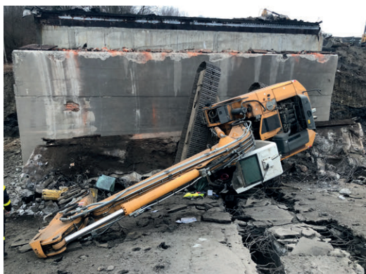
Obr. č. 13.5 Pád bagru s mostem
